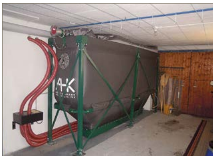
Abb. 10b: Trogsilo mit mehreren Saugentnahmepunkten
